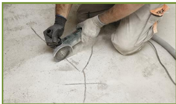
Нарязване на пукнатината на правилни ъгли по нейната дължина.
